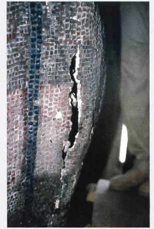
Aufgeplatze, abstehende Mosaikoberfläche mit grosser Hohlstelle
