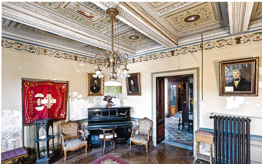
Torricella, la «Sala dei ritratti». Si nota il soffitto in stile neoclassico riccamente decorato. Sulle pareti si vede il deterioramento delle stesse a causa dell'umidità. (Foto Michael Peuckert)
