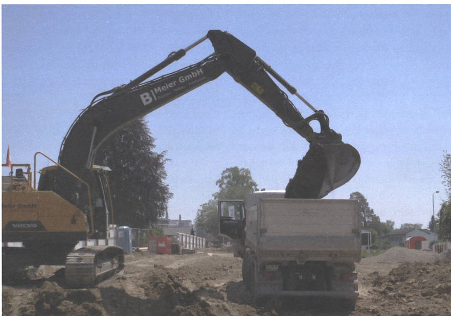
Fünf Meter tief wird die Ackerfläche für den geschützten Platz für Autos ausgeschöpft.
