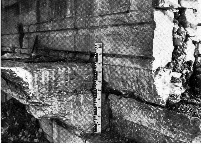
Hauptgesims, gegen Süden. Die ausgebauten Quader hinterlassen erhebliche Lücken.
