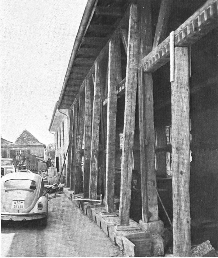
Die Lasten des Daches wurden zum Ausbaggern des Kellers auf einem Betonriegel abgefangen.
