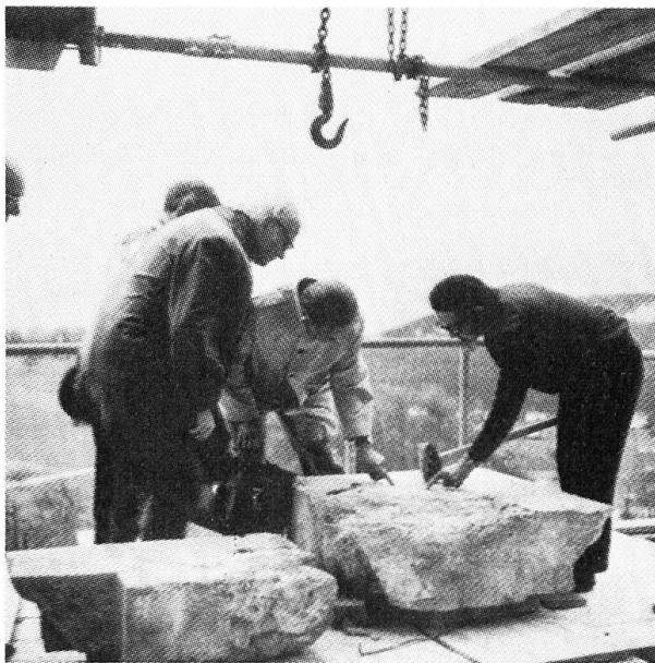
Fritz Lauber, Vizepräsident der Eidgenössischen Denkmalpflege, inspiziert schadhafte Werkstücke auf der Baustelle.
