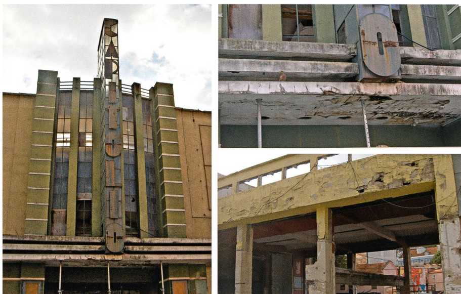
Cristino da Silva, Capitólio, Lisbonne, 1931. Projet de reconstruction du lieu original conçu par Souza Oliveira. Façade principale et latérale, et détails datant de la première démolition.
