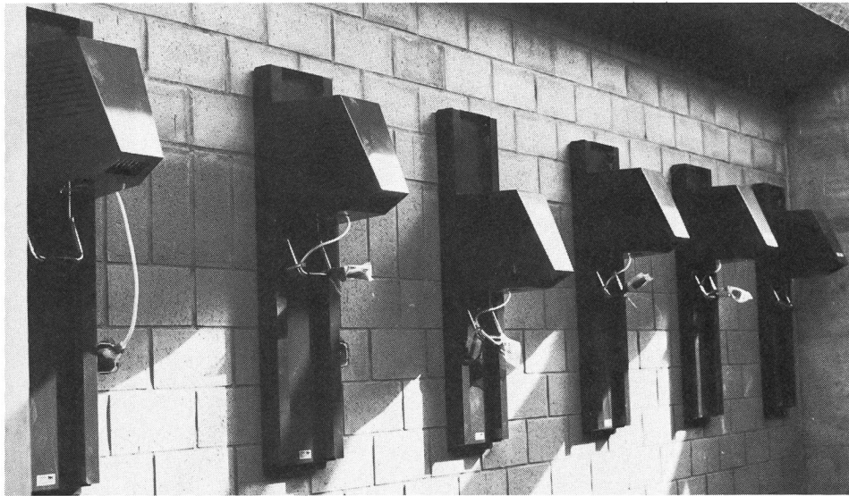
Die Föhn-Batterie im Durchgang.
