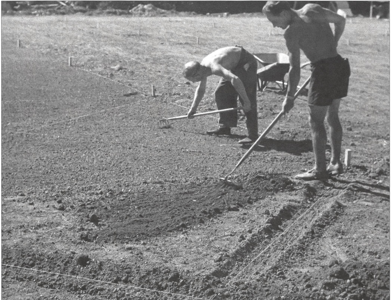
Früher beim Bau von Sportanlagen oft angewendet – die Fronarbeit. In den letzten Jahrzehnten ist es um sie eher still geworden. Stehen wir vor einer Renaissance?
