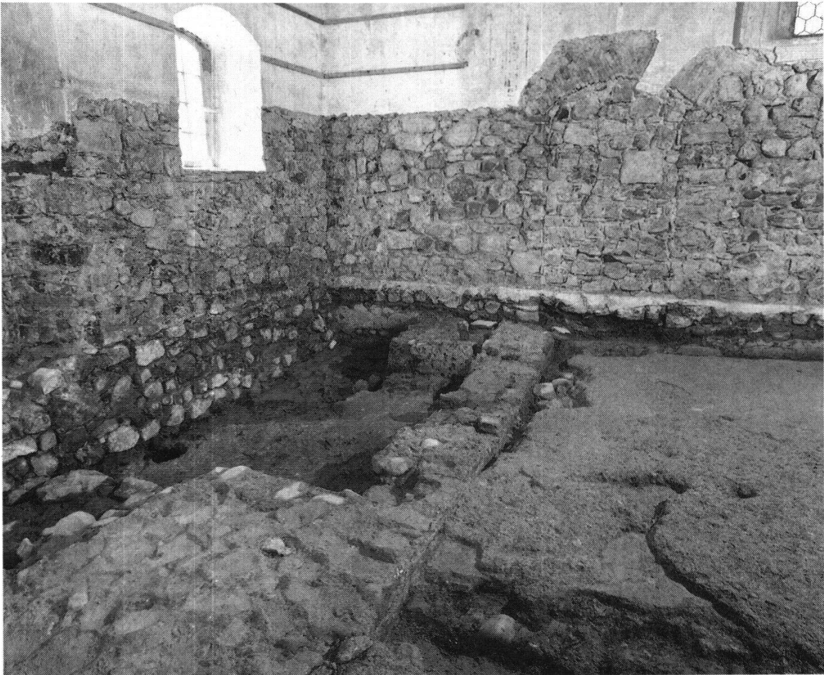
Abbildung 9 Steinen. Ansicht gegen die Nordwestecke der bestehenden Kapelle. Übernommene Ausstattungselemente aus der Zeit der Zisterzienserinnen. Sichtbar ist die Trennmauer und links im Vordergrund der im Verband mit dieser entstandene Kreuzaltar sowie, an die Nordwand gelehnt, der nachträglich errichtete Maria-Magdalena-Altar. In der Nordwand ist die beim Bau der Kapelle zugemauerte ehemalige Totenpforte zu erkennen.
