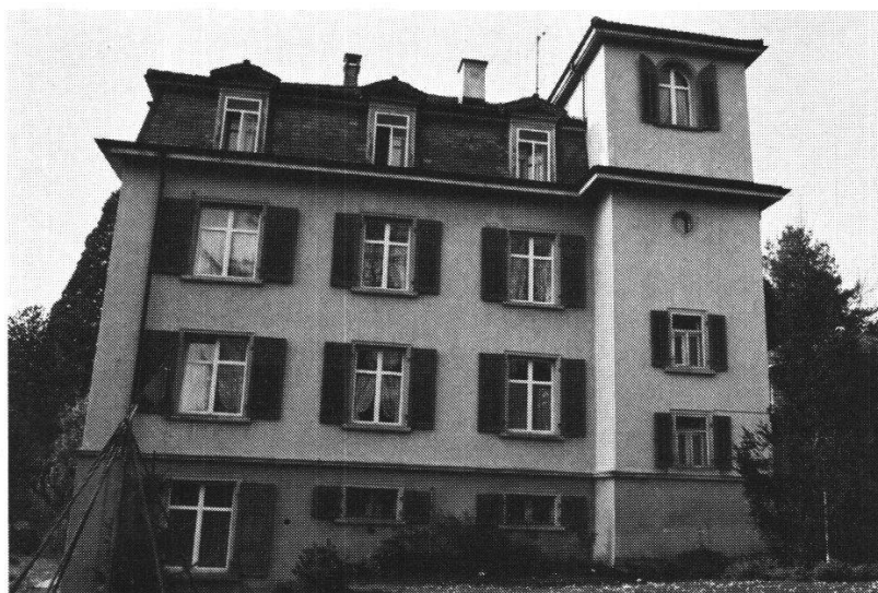
Schwyz, Villa Landtwing, Bahnhofstraße, vor der Restaurierung. Durch das Abräumen aller dekorativen Elemente verlor das Haus seinen prägnanten Charakter vollständig.
