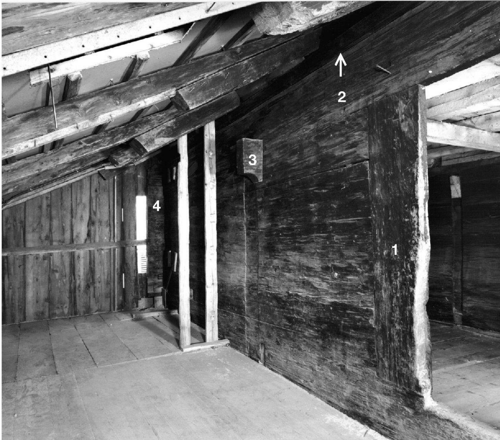
Abb. 22: Nordwand der Südlaube (2.4). 1: Türpfosten; 2: über die gesamte Hauslänge reichende horizontale Nut im obersten Balken; 3: Einzelvorstoss; 4: Gesamtvorstoss mit Angabe der vormaligen Dachschräge.
