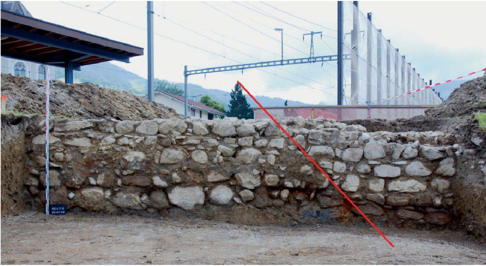
Abb. 17: Feindseitiger Mauermantel des Letzimauerfundaments, von Nordosten. Der schräge Strich markiert die mögliche Lage der Trennlinie zwischen den zwei Baulosen – links mit Fundamentgraben, rechts mit Pfahlfundament.
