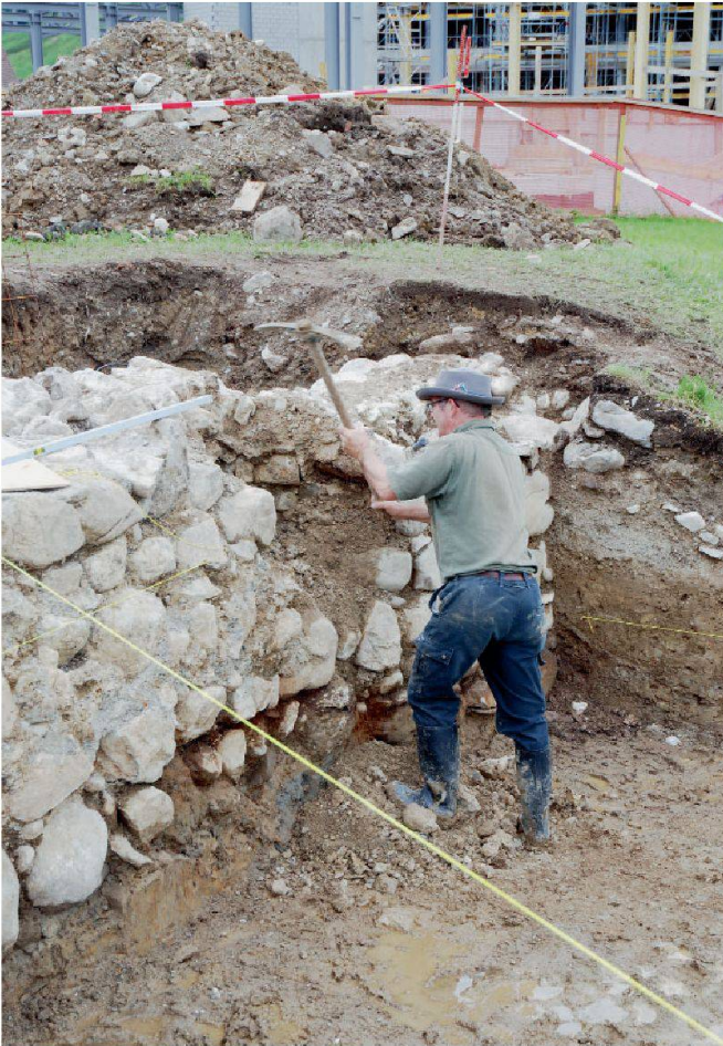
Abb. 6: Letzi Rothenthurm 2009. Hubi Blättler beginnt mit dem Ausbrechen der Mauerbresche, von Nordosten.
