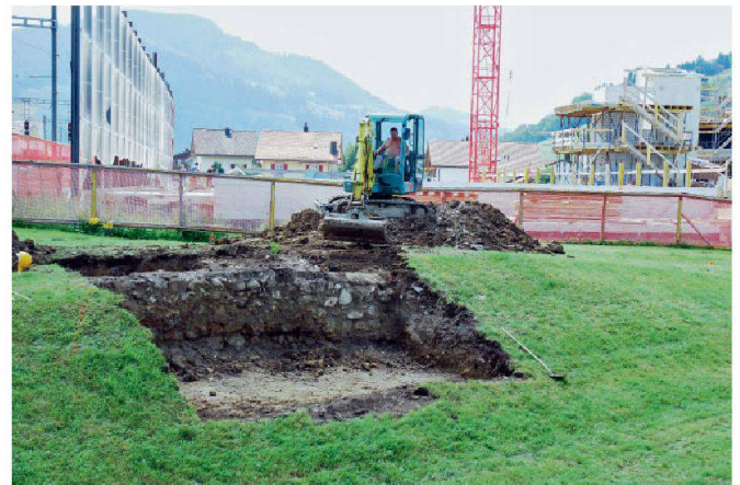
Abb. 1: Letzi Rothenthurm 2009. Freilegen des Fundamentes der Letzimauer mit Hilfe eines Kleinbaggers, von Norden. Im Hintergrund die Baustelle Schulanlage MPS (Mittelpunktschule) Berg.
