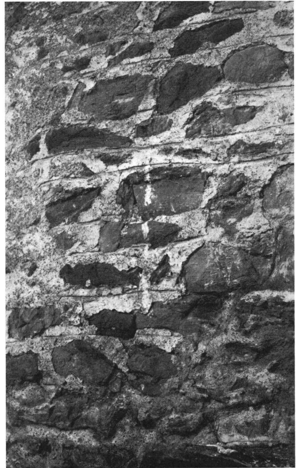
Gräpplang bei Flums SG. Burgruine. Romanischer Verputz am Palas mit den rot bemalten Chellenstrichfugen.
