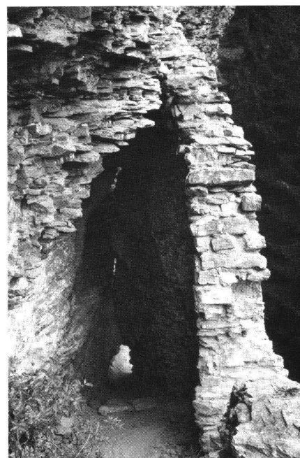
Abb. 1 Mollens 1 VS, Rochers des Echères. Unterer Bau. Ansicht des Wandabbruches.
