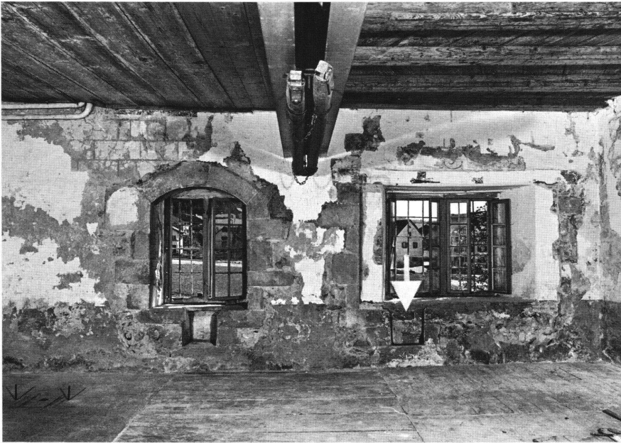
Ostwand des Ostraumes im Obergeschoss des ehem. «Einsiedlerhauses». Das Bild zeigt die beiden Sitznischenfenster (-spuren) mit dem vorstehenden Verputz mit roter Quaderung.
