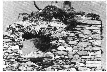
Splügen GR. Schwere Schäden im Kronenbereich, verursacht durch das Wurzelwerk einer mittlerweile abgestorbenen Föhre. Man beachte, wie der oberste Eckstein durch den Wurzeldruck aus seiner ursprünglichen Lage geschoben worden ist.
