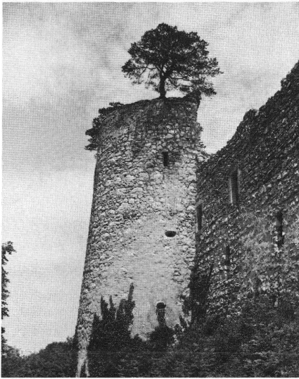
Dorneck SO. Der mächtige Baum auf der Turmkrone setzt bei Windstößen Mauermassen von mehreren Kubikmetern Inhalt in Bewegung und bewirkt so die allmähliche Zersetzung des Mauergefüges.
