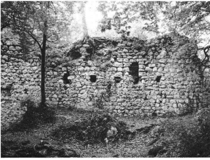
Schalberg BL. Deutlich ist zu erkennen, wie die Mauerkrone durch das Wurzelwerk zerstört wird.
