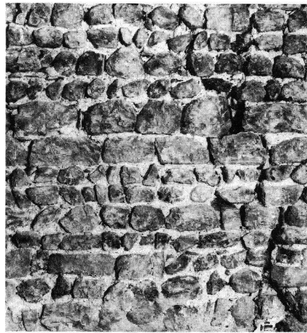
Abb. 16: Innenansicht der «Glentnerturm»-Westfassade im 2. Obergeschoss. Lagenhaft gemauerte Mauerschale aus Bollen- und Lesesteinen.
