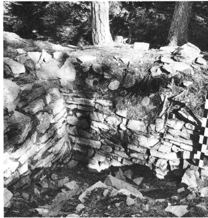
Ober-Ruchenberg bei Trimmis (GR). Von Schatzgräbern freigelegter Mauerwinkel, trocken geschichtet, im bergseitigen Vorburgareal. Mauerkante mit deutlichen Auflösungserscheinungen.
