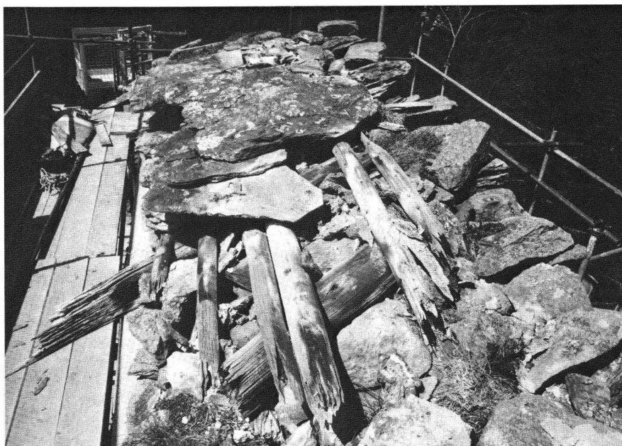
Cagliatscha, Dachpartie teilweise abgedeckt.
