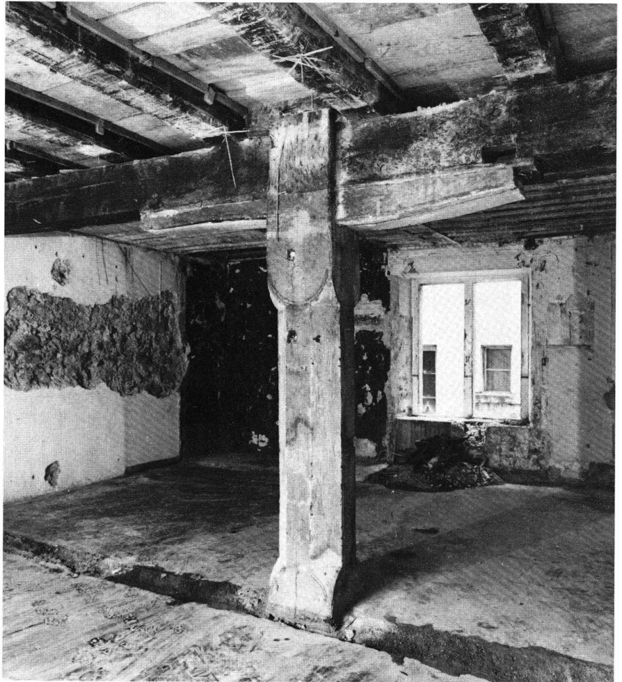
9 Widdergasse 6. Die Stützkonstruktion mit Stud, Sattelholz und Unterzug gehört in die Zeit um 1300.
