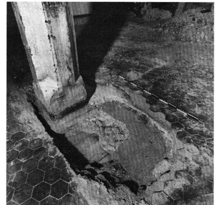
10 Unter dem modernen Küchenboden hat sich der originale Bodenaufbau, Bodenbretter und Rollierung mit Mörtelguss erhalten.
