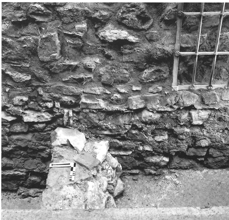
Innenseite der Turmmauer M 1d und Aufsicht der Mauer M 2. Der Mörtel der Mauer M 1d ist bis UK Gitter original. Der darüber sichtbare, glattgestrichene Fugenmörtel wurde bei der letzten Konservierung aufgetragen. (Aufnahme Ph. Saurbeck)
