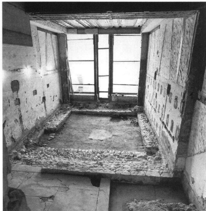
7: «Vorderer Schwert-Turm», Blick von Norden ins 6 m hohe Erdgeschoss des Turmes; der mächtige Mauersockel von 1,8 m Stärke wurde im 19. Jahrhundert aufgebrochen.
