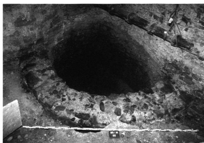
9: Die Befestigung der St. Alban-Vorstadt mit einem Schalenturm, der nachträglich als Latrine benützt wurde (St. Alban-Vorstadt 30/32).
