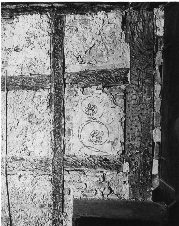
16: Mit Bollenfries gefasste Rankenmalerei im Riegelfeld an der Nordwand im Gang des zweiten Obergeschosses, während der Umbauarbeiten 1959–1960.
