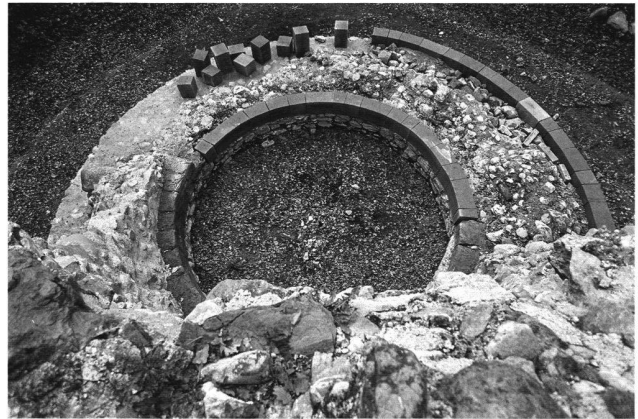
Fig. 22. Vue plongeante sur les vestiges de la tour sud-est en cours de consolidation et de restauration partielle. – Sicht auf die Mauerreste des Südostturmes während der Sicherungs- und Restaurierungsarbeiten. Da für die Mantelsteine kein brauchbarer Stein in der Nähe zu finden war, wird ein rötlicher Sandstein aus den Vogesen zum Wiederherstellen der Mantelmauer verwendet.
