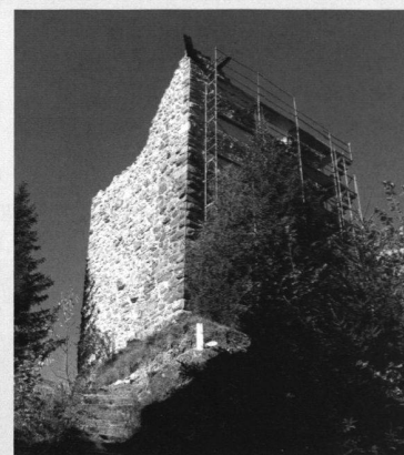
2007: Die Südfront ist gesichert, zwei neue Lärchenstümpfe lokalisieren die verfallenen Kragbalken der Wehrlaube.
