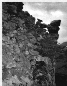
Vorzustand 2001: Die Mauerkrone ist völlig aufgefallen, die Ecken können jederzeit einstürzen.
