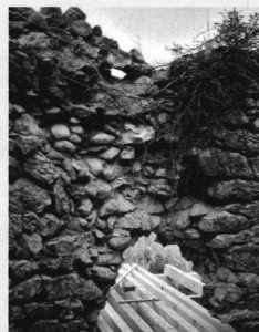
Vorzustand 2001: Die beiden Hälften der Nordwand werden nur noch durch eine dünne Brücke aus Füllwerk gestützt.
