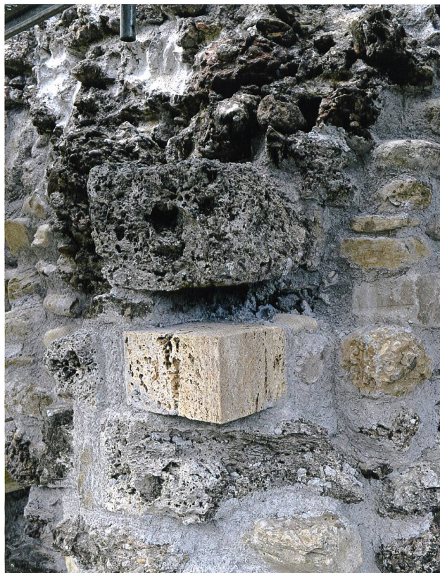
4: Schänis SG, Ruine Niederwindegg, 2020. Ecke M1/M2. Zur Stabilisierung der originalen bossierten Tuffsteinquader eingesetzt Ersatzstein mit glatter Oberfläche, von Norden. Vor dem Schliessen der Lücke wurde zur rückwärtigen Verankerung der Ecke eine Ankerstange aus Chromstahl eingesetzt.
