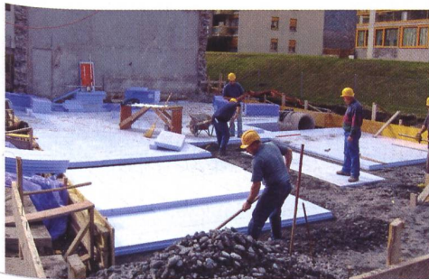
Sur des fondations parasismiques, les plaques d'isolation sous le radier atteignent 20 centimètres d'épaisseur.
