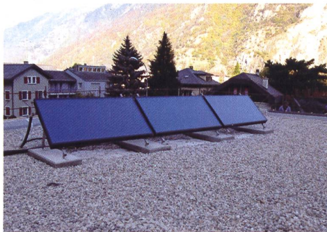
Les panneaux solaires sur le toit assurent le préchauffage de l'eau sanitaire.
