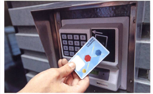
L'accès au bâtiment est seulement possible avec un badge.
