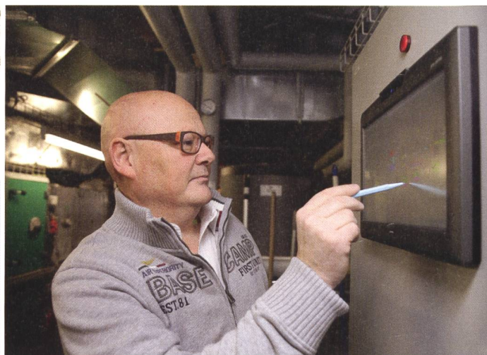
Manuel Gsteiger de la société ECE contrôle la bonne marche des installations techniques, notamment en ce qui concerne les échanges thermiques dans le bâtiment.
