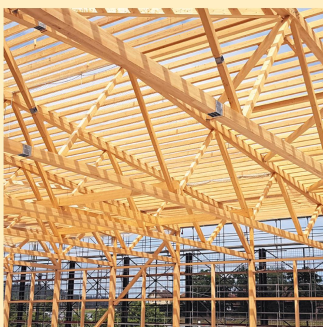
Palaghiaccio Pruntrut – Pilastrì e supporti nel fabbricato annesso e sulle tribune
