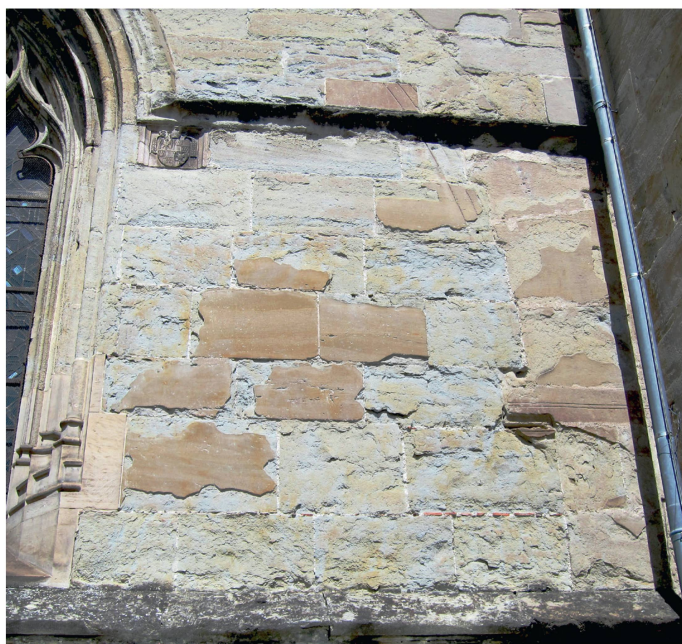
1 Cathédrale de Lausanne, nef, travée a, façade sud, état au 23 avril 2012. Exemple de parement affecté par des altérations en plaques pas encore traitées (Photo CSC Sàrl).
