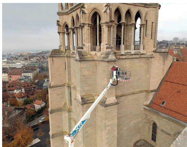
3 Les cibles nécessaires à l'orientation et au géoréférencement des clichés photogrammétriques ont été placées en divers endroits des façades à l'aide d'un camion nacelle.
