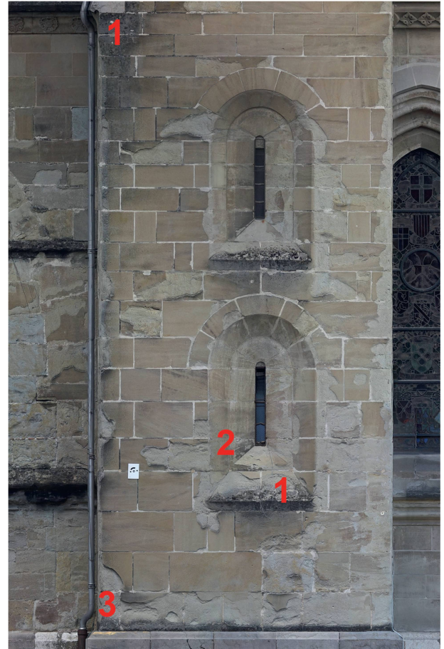
8 Exemples de colonisations biologiques (1), crottes (2) et lacunes (3) sur la façade sud de la cathédrale.
