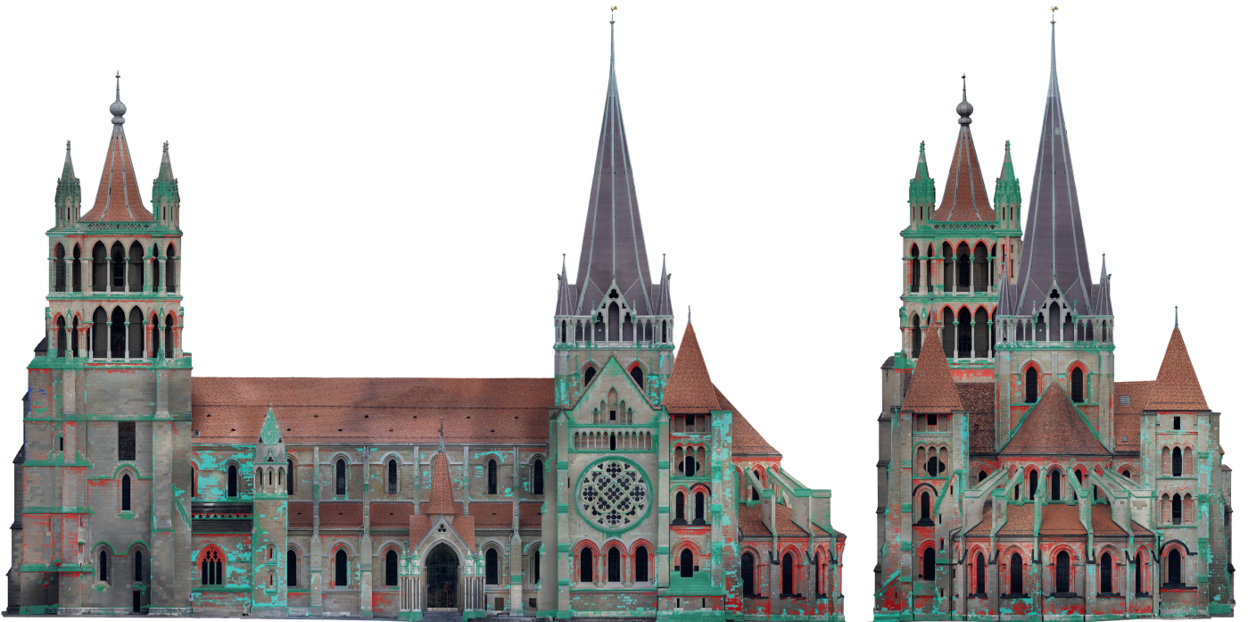
C2 Pathologies des façades sud et est : la façade est, plutôt abritée de la pluie, est impactée par la présence d'anciennes croûtes noires.
