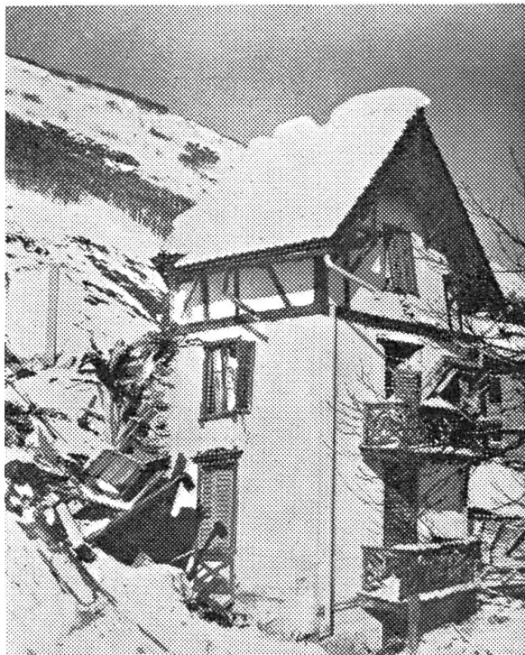
Im bündnerischen Vals haben die Lawinen auch fürchterlichen Schaden angerichtet. Von diesem Haus riß die Lawine die Hälfte weg
