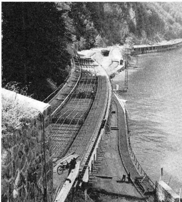
Im Juli 1965 Blick vom Buchenloch Richtung Dreckloch. Im Vordergrund links das Tunnelportal Nord, anschliessend Armierung und Vorspannkabel des Lehnenviaduktes. Foto Hans Diener
