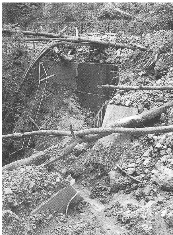
15. Juli 1999. Überfüllter Geschiebesammler des westlichen Seitenarms des Hinter-Erlibaches an der Werkstrasse 3. Das überflossene Material dieses Sammlers führte nie zu einer Behinderung bei der Emmetterstrasse.
