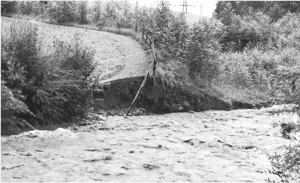
Einer der Uferanbrüche hat an dieser Stelle den Bikeweg nach Engelberg unterbrochen.
