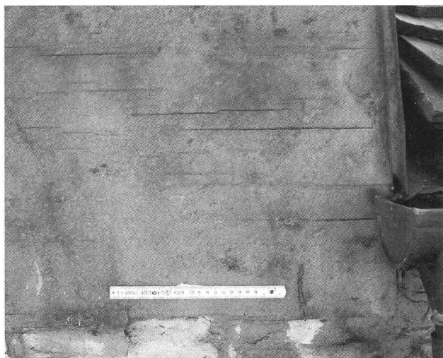
Stans, Winkelrieddenkmal. Schadensbefund: Rissbildungen am Sandstein.
