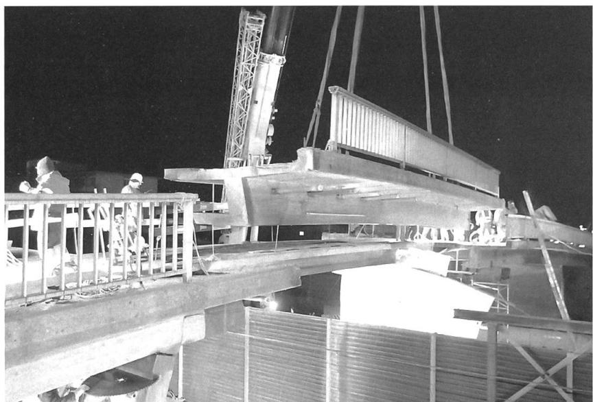
23.11. Brücke in Stücken weg.
