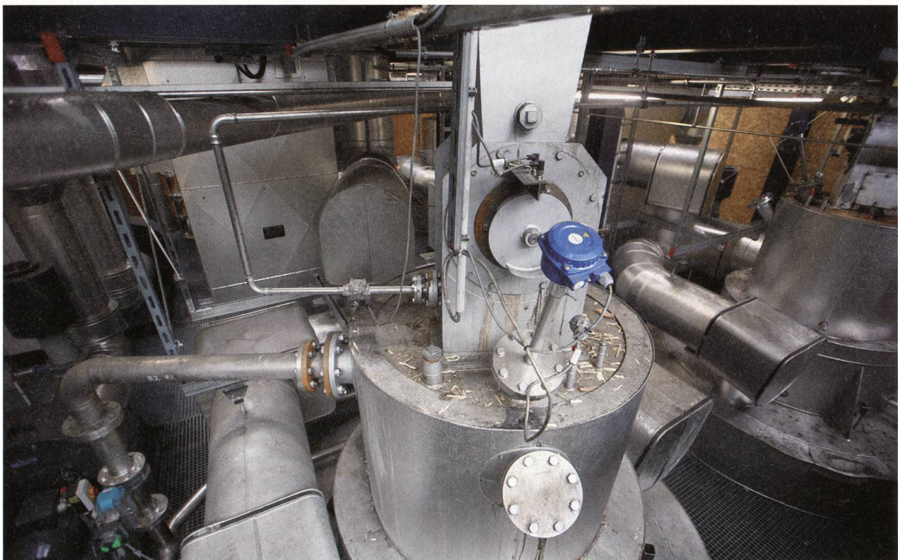
Die zweite Ebene in der Holzverstromung. Vorne das Mittelteil der Holzvergasung, die sich auf drei Ebenen ausdehnt.
