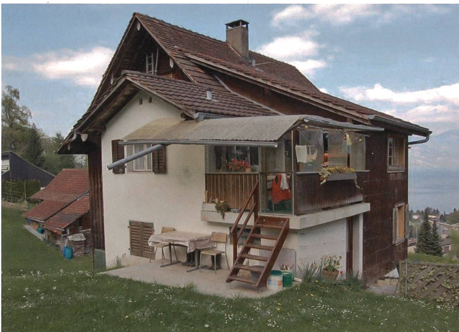
Vorher: Altes Bauernhaus in Hergiswil, renovationsbedürftig.
