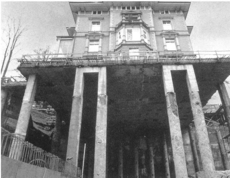
Zürich: beim Bau der sogenannten Ami-Klinik wurde ein Teil der ursprünglichen Bau- substanz «unterhöhlt» (Bernhard Furrer)
