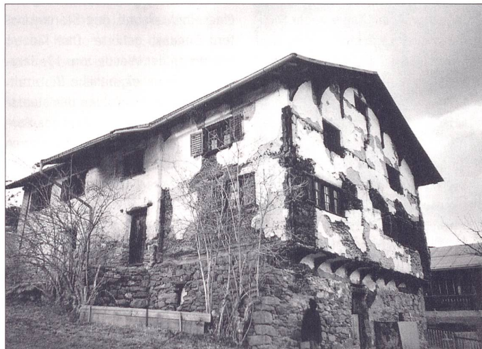
Das Baudenkmal Casa Demont im bündnerischen Vella wurde vor kurzem abgebrochen, obwohl die Gemeinde dies dem Eigentümer untersagt hatte. Der Schweizer Heimatschutz hat Strafanzeige eingereicht.
