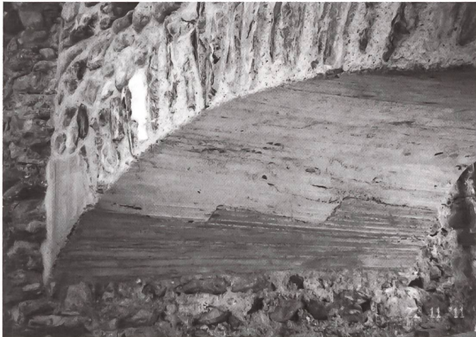
Ramosch (GR), Burgruine Tschanüff. Untersicht des ausgeschalteten Unterfangungsgewölbes. Unten das gestufte Widerlager aus Beton.
