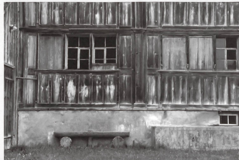
Wird heute ein Ersatzbau nicht bewilligt, so bleibt der Altbau oft leer und zerfällt. Hier möchte die Gesetzesrevision zu Ungunsten der bestehenden Bausubstanz Abhilfe schaffen.
