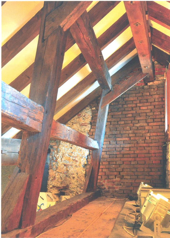
Das in der Spittelscheune erhaltene Teilstück des alten Wehrgangs wurde restauriert und vom Zunftlokal aus begehbar gemacht.
