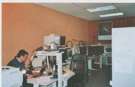
Abb. 12: FERNANDO SELMAN an der Arbeit im Kontrollraum.
