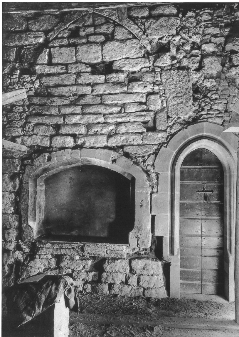
Fig. 10 Le mur oriental du collatéral nord en 1938, actuellement caché par l'autel du Rosaire. On distingue en haut les traces d'arrachement de l'arc formeret d'une chapelle du premier tiers du XIV e siècle. La porte, percée vers 1430, donne sur le clocher.
